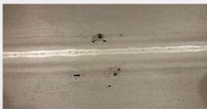
Figura 1 - Exemplo de corrosão por pites em aços inoxidáveis.
