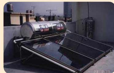
Aquecimento solar para água, Taiwan, China
