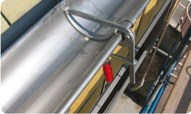
União de calhas, em 430 Ti revestido de estanho.
